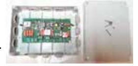
Centrale locale caldaia
